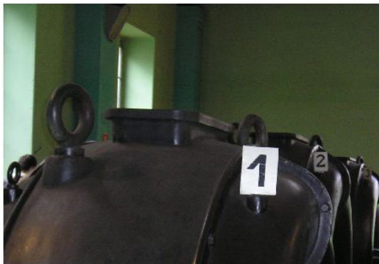
Jeden z pracujących hydrozespołów Zdjęcie nr 2
